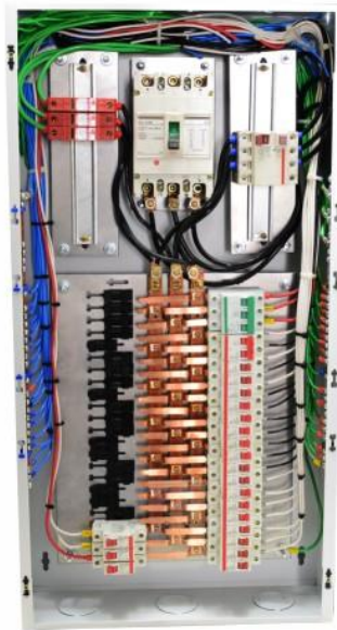
Figura 12: Quadro de Distribuição
